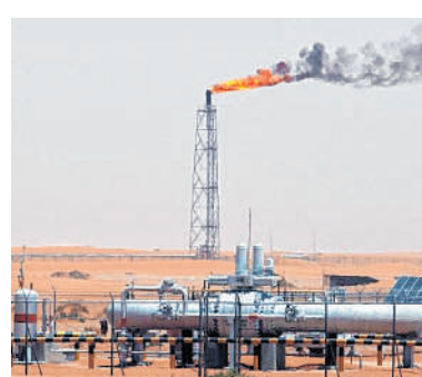
Technische Anlagen auf dem Khurais-Ölfeld bei Riad (Saudi-Arabien). BILD: DPA
